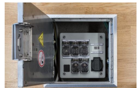
Bodentank – Anschluss für Signalquellen
