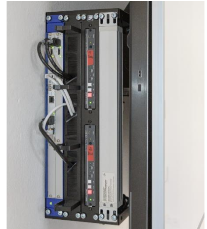
Seminarraum Haus 14 - Technikrack
