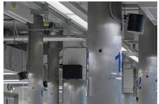
Präparationssaal Haus 91 – Befestigung Lautsprecher
