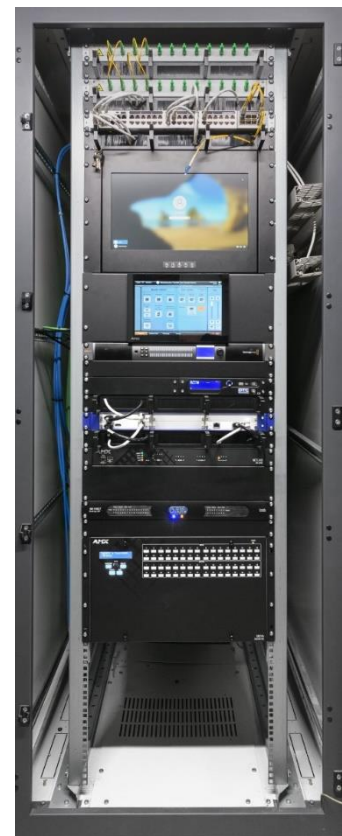
Abgesetzter Technikschrank im Kellergeschoss
