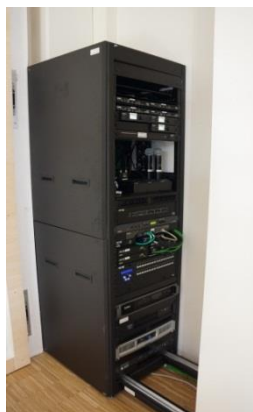
Technischrank im Wandschrank installiert
